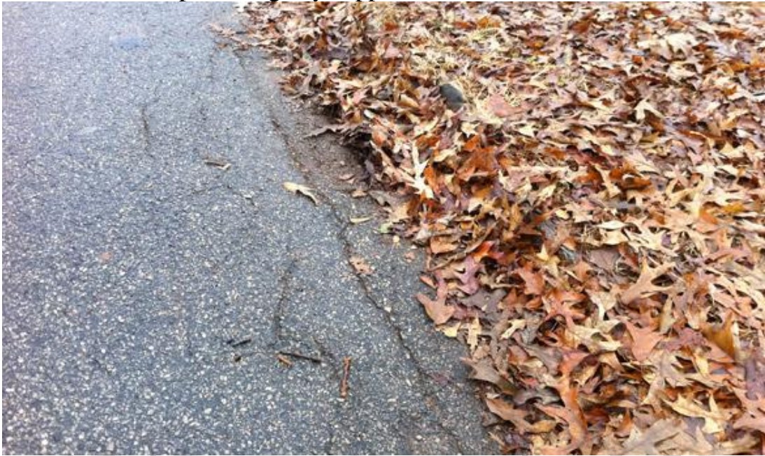
Fig. Edge Cracks
