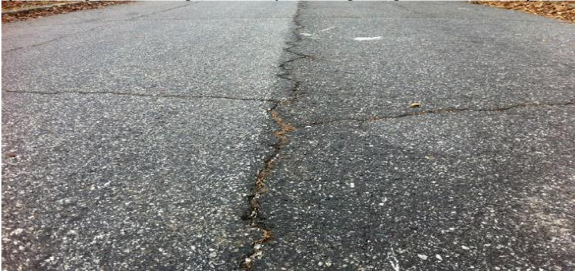
Longitudinal (Linear) Cracking
