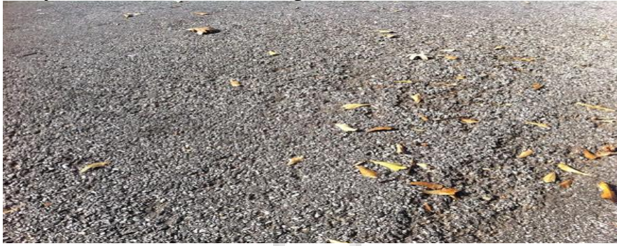
Fig. Raveling (very porous asphalt)
